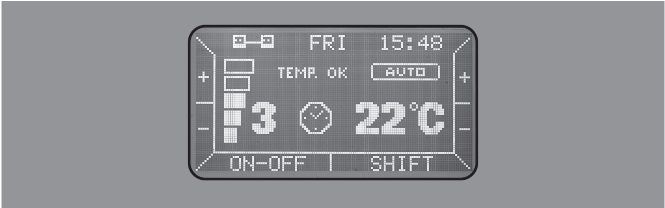
Abb. 11: Display-Anzeige bei Automatikbetrieb
